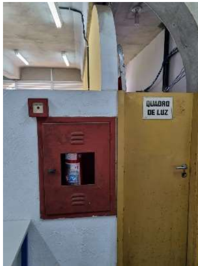
Figura 9 - - O extintor está alocado na caixa de mangueira de incêndio
