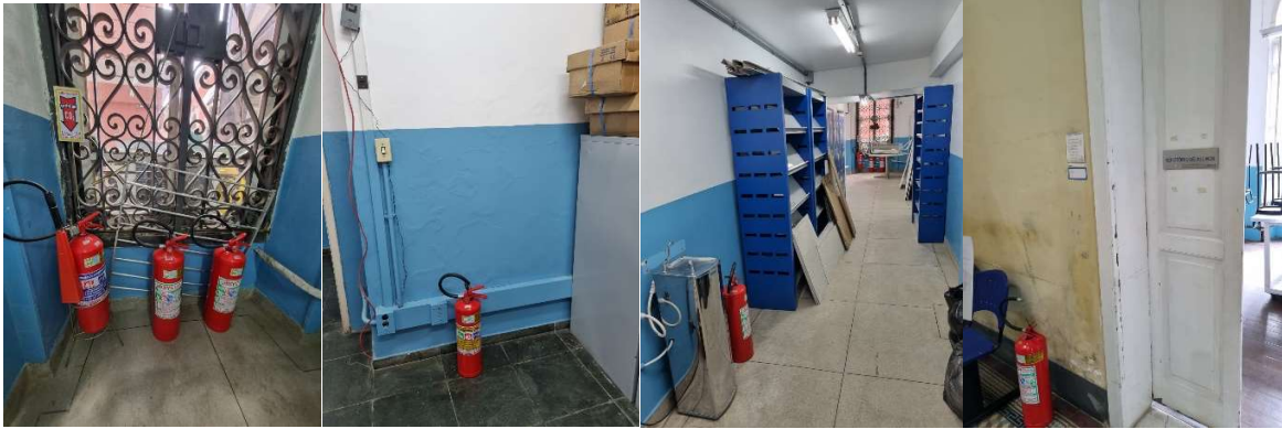
Figura 4 – O extintor não se encontra instalado corretamente
