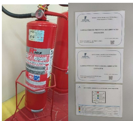
Figura 11- – Boas práticas relativas à prevenção de incêndio e pânico
