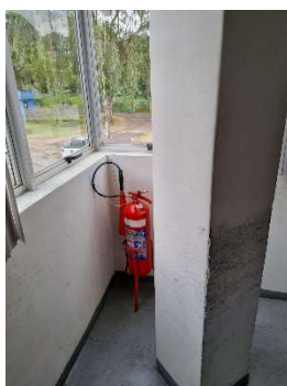
Figura 7- O acesso ao extintor está obstruído e sem sinalização
