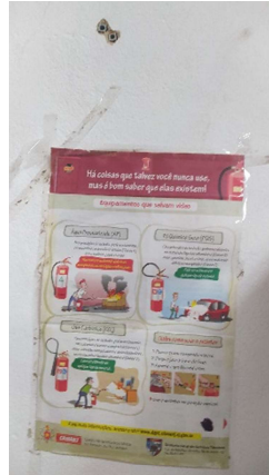
Figura 19- O acesso ao extintor está obstruído e sem sinalização
