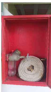
Figura 12– Caixa de mangueira de incêndio desconectada
