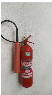
Figura 14 – Extintor sem tombo e sinalização
