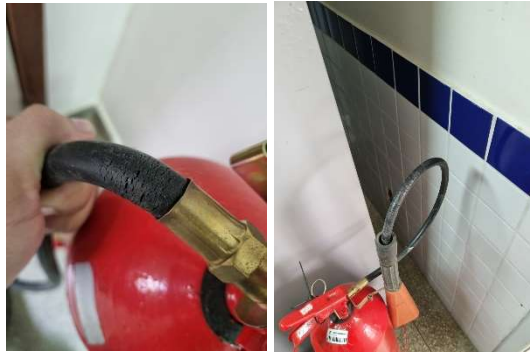
Figura 8 - A mangueira apresenta rachaduras ou perfurações
